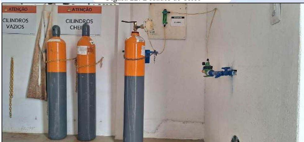
Figura 22: Dosador de Cloro
