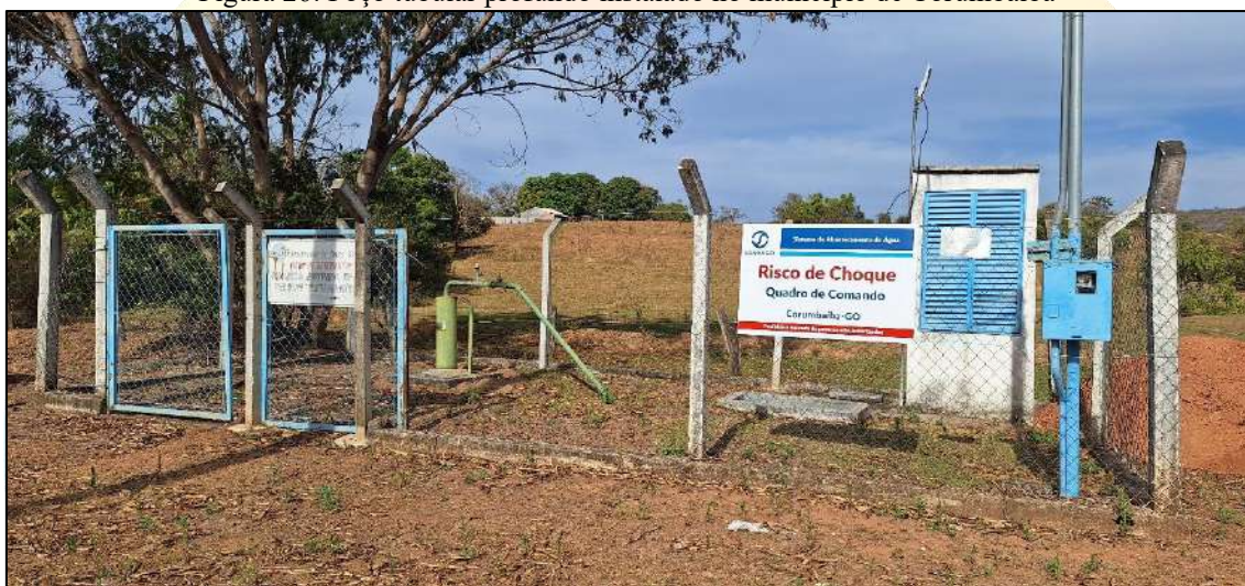
Figura 26: Poço tubular profundo instalado no município de Corumbáiba
