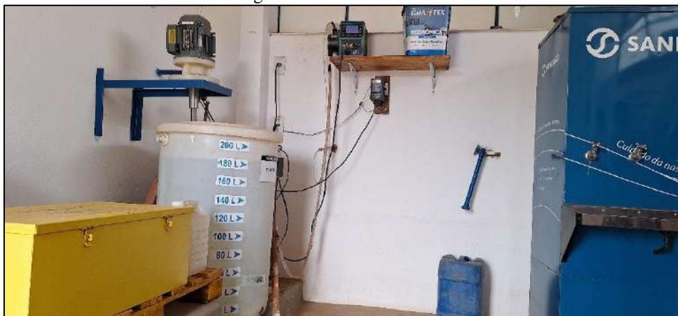
Figura 23: Dosador de Flúor
