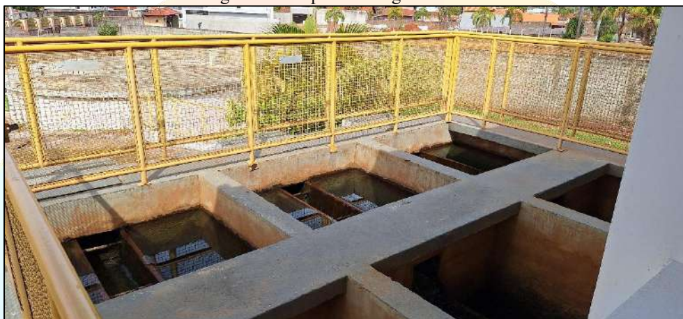
Figura 21: Etapa da filtragem na ETA
