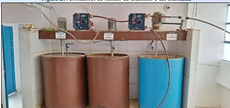
Figura 20: Dosadores de sulfato de alumínio e cal hidratada
